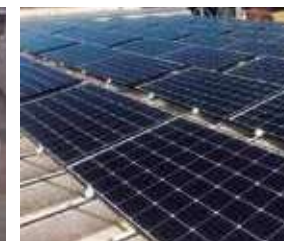
日油技研工業㈱ 太陽光発電パネル
