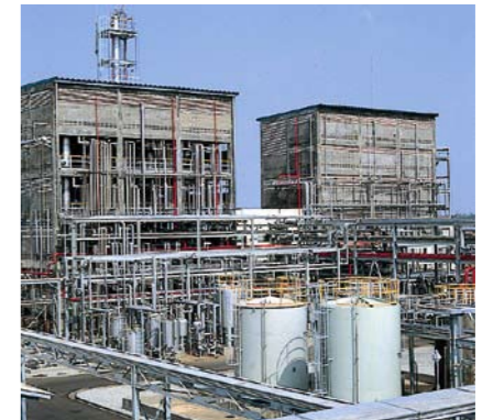
PT.NOF.MAS.CHEMICAL INDUSTRIESの製造プラント
