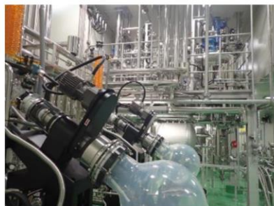
脱溶媒設備 (ロータリーエバポレーター)
