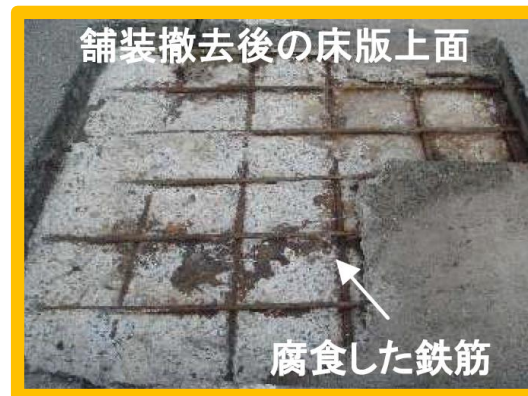
塩害による鉄筋の腐食
