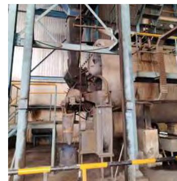
バイオマス燃料を用いたボイラー
