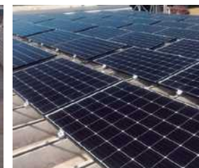
日油技研工業㈱ 太陽光発電パネル
