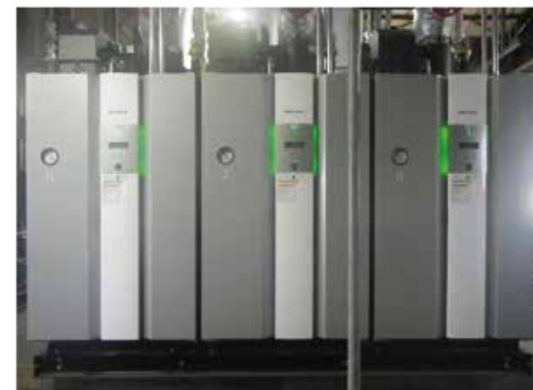
武豊工場で燃料を都市ガスに替えたボイラー (2025年1月稼働)
