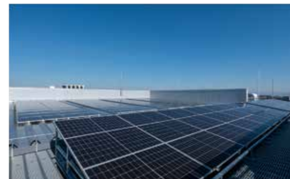
LS愛知工場の太陽光パネル（2025年4月稼働）
