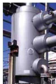
PFC冷却回収用コンデンサー（写真はPFCタンクに付帯のもの）
