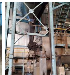
バイオマス燃料を用いたボイラー
