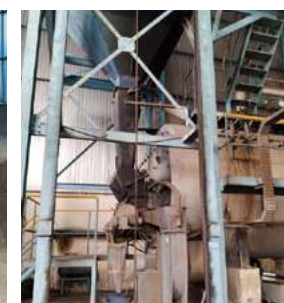
バイオマス燃料を用いたボイラー
