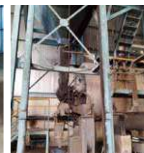
バイオマス燃料を用いたボイラー
