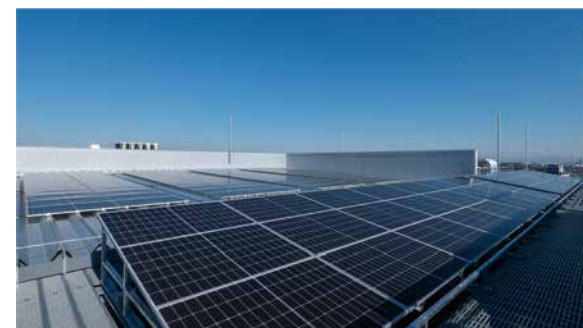
LS愛知工場の太陽光パネル（2025年4月稼働）
