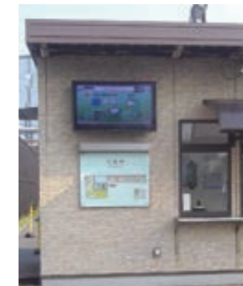
発電監視モニター
